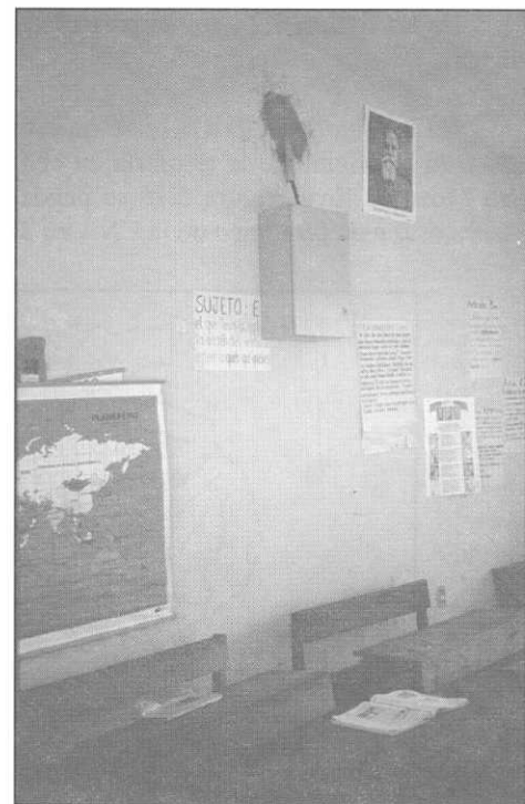
Figura 5.3 Gabinete con el equipo de registro y comunicaciones dentro de un salón de clases, estación Ignacio Allende
