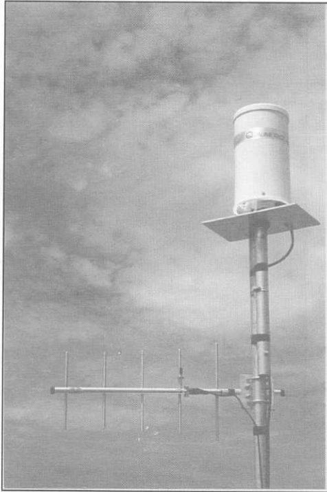
Figura 5.9 Detalle del montaje del pluviómetro y la antena de radio sobre un poste
