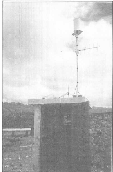
Figura 5.8 Instalación de la estación Vicente Guerrero VG-03 en una caseta de concreto
