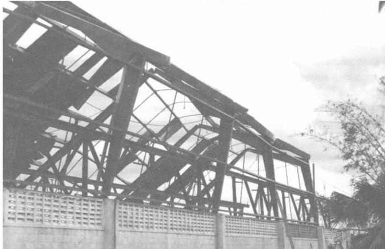
Figura 4.13 Comportamiento inadecuado de una estructura tipo nave industrial por corrosión debido a intemperismo de los tornillos de unión en las vigas de los marcos
