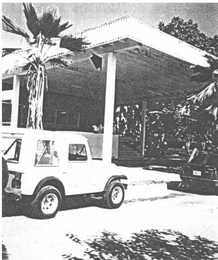
FOTO 2 Entrada por la zona de estacionamiento. Nótese la esbeltez de las columnas, así como la unión precaria del sistema viga-columna.
