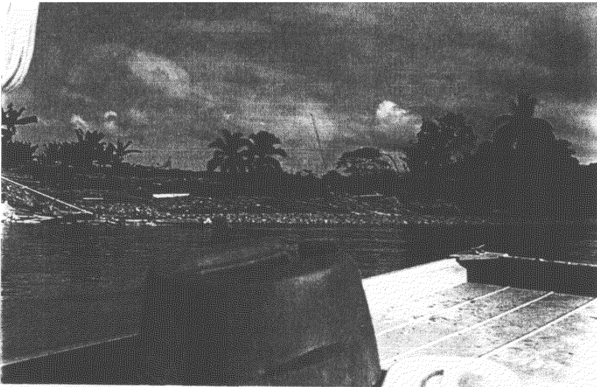
SOCAVACION MARGEN IZQUIERDA FINCA MARGARITA
