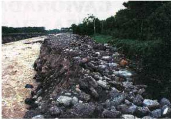
Foto # 8: Borda no estructurada construída en la ribera del río Samalá en 1,999. El flujo erosiona las bordas de tal forma que se derrumban y pronto dejan de ser funcionales, en este caso, en cuestión de dos meses. Por tal motivo se debe construir bordas gavionadas que no presenten deficiencias de desmoronamiento.
