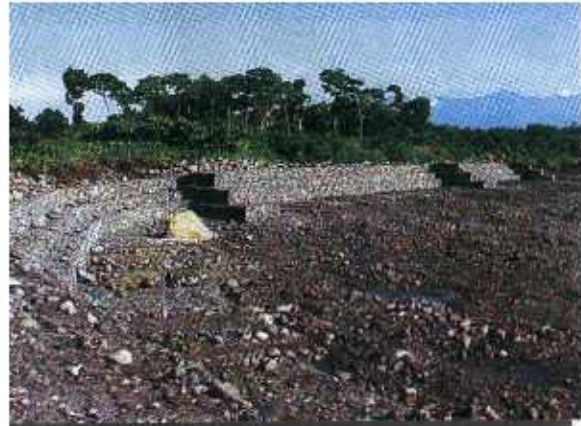
Foto # 12: un segmento de la borda gavionada de San Sebastián, mostrando la estructura triangular, así como dos de los 5 espigones que desvían el flujo de agua del río para minimizar los efectos de erosión y desmoronamiento.
