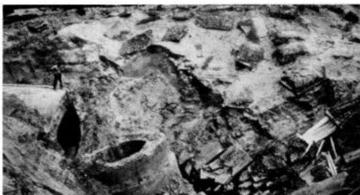
Figura 3-2 Torre de captación que colapsó en San Fernando, California
