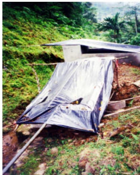
Vista del sedimentador y filtro y cubiertas de plástico colocadas sobre las estructuras.
