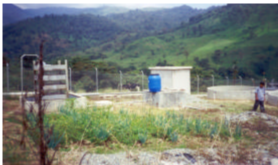
Vista general de los componentes de la planta de tratamiento de agua potable, aireador, caseta de cloro, y tanques de reserva en la planta de tratamiento de agua potable para la población de Sardinas .
