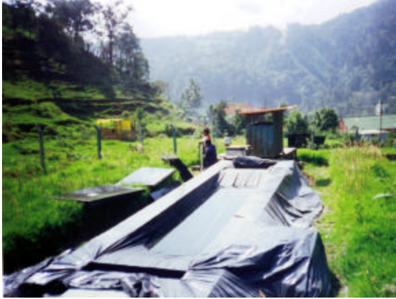
Vista general de las estructuras de la planta de tratamiento, con la cubierta de plástico, en el sistema de agua potable de la población de Atenas, Provincia del Sucumbíos. 2003. Fuente: COOPI.
