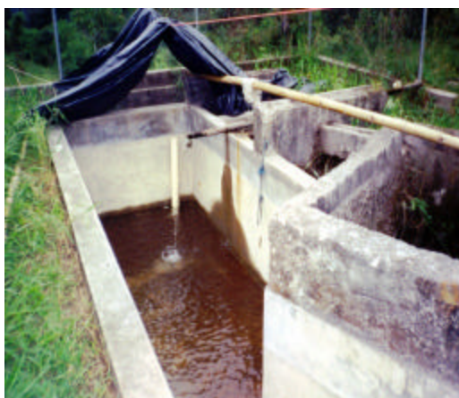
Estructuras y tanques de floculación en el sitio Cascabel, cantón Lumbaqui, Provincia del Sucumbíos. 2003. Fuente: COOPI.
