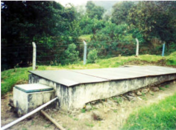
Estructura de captación protegidas con cubiertas metálicas durante la emergencia, en el sistema de agua potable de la población de Atenas, Provincia del Sucumbíos. 2003. Fuente: COOPI.
