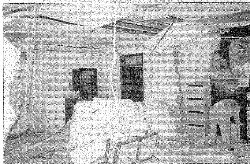
Ilustración No. 9 Terremoto en Bahía de Caráquez. Detalle del daño estructural.
