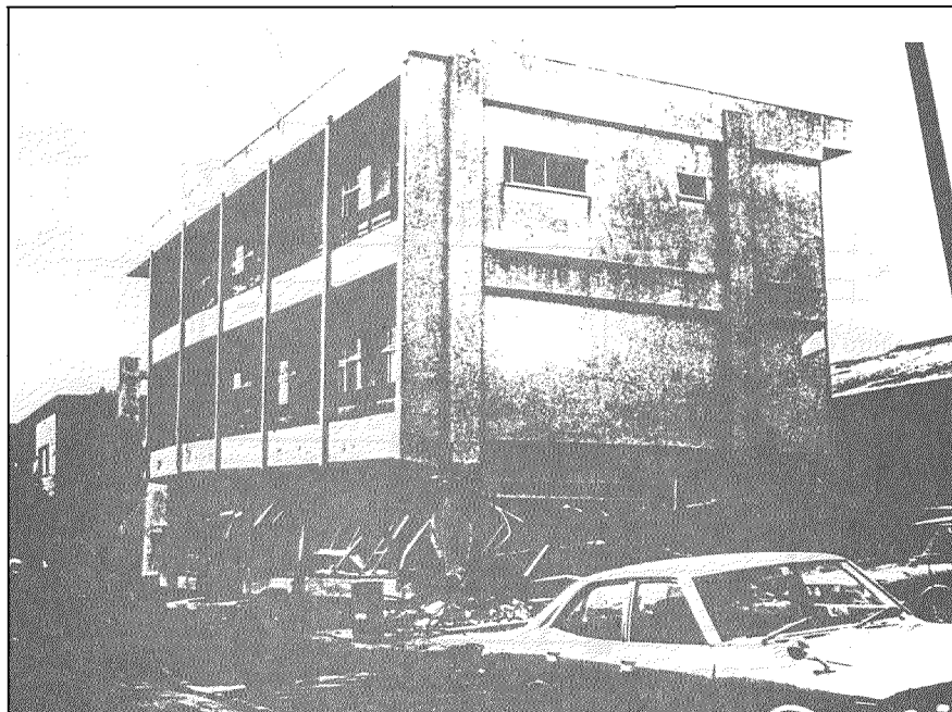
Fig. 6: Daño debido al efecto torcional
