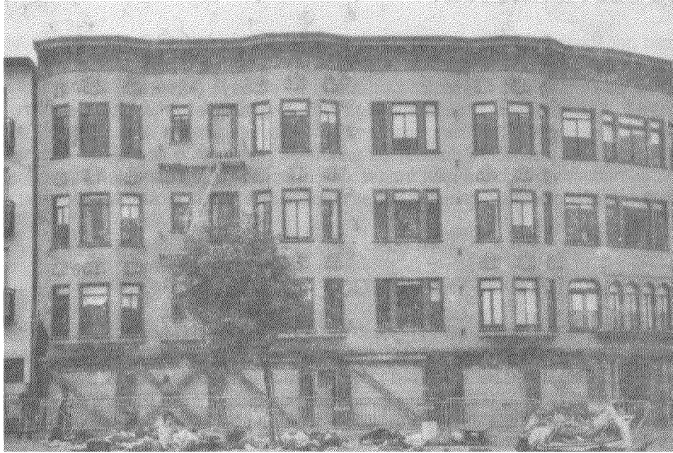
FOTO 5.1: DAÑO TÍPICO EN EDIFICIOS CON GARAGES EN EL PRIMER PISO EN EL DISTRITO DE MARINA, SAN FRANCISCO.
