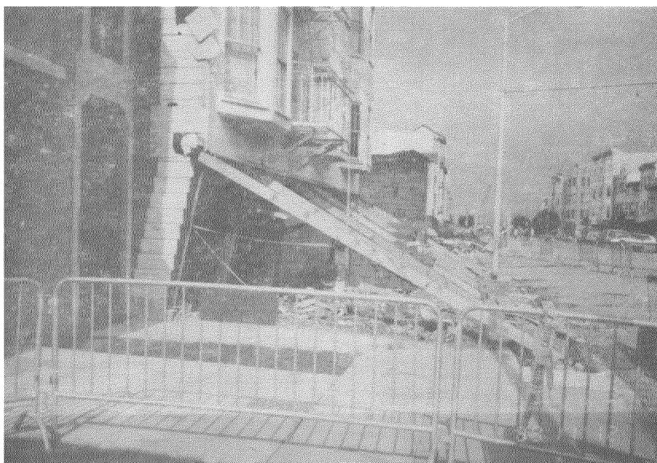
FOTO 5.4: DAÑOS A LOS ELEMENTOS RESISTENTES HORIZONTALES, MARINA, SAN FRANCISCO
