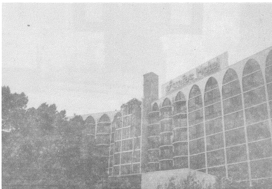
FOTOS 5.10: DAÑOS EN EL PENTHOUSE DEL HOTEL AMFAC CERCA AL AEROPUERTO DE SAN FRANCISCO
