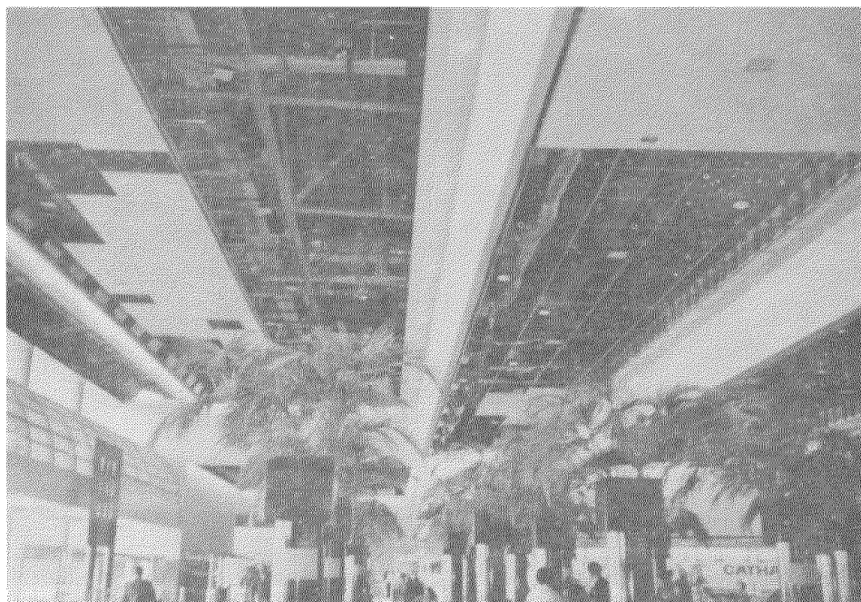
FOTO 5.11: DAÑOS EN EL CIELO RASO DEL EDIFICIO TERMINAL DEL AEROPUERTO DE SAN FRANCISCO
