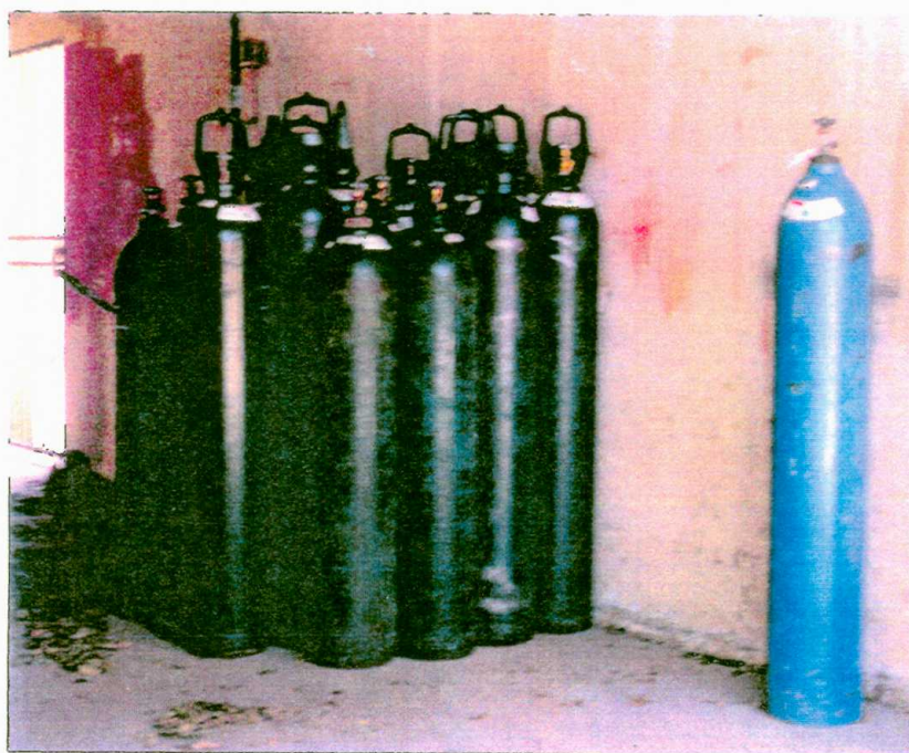
FOTO 1 Bombonas de Gas y Oxígeno que requieren dispositivos de fijación (Hospital Dr. Antonio Patricio Alcalá, Cumaná).
