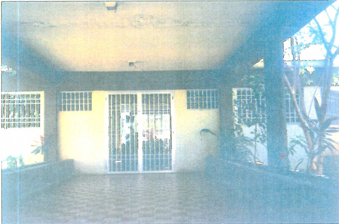
FOTO 15 Entrada al Edificio de la Unidad de Oncología. Nótese la humedad en el techo del pasillo
