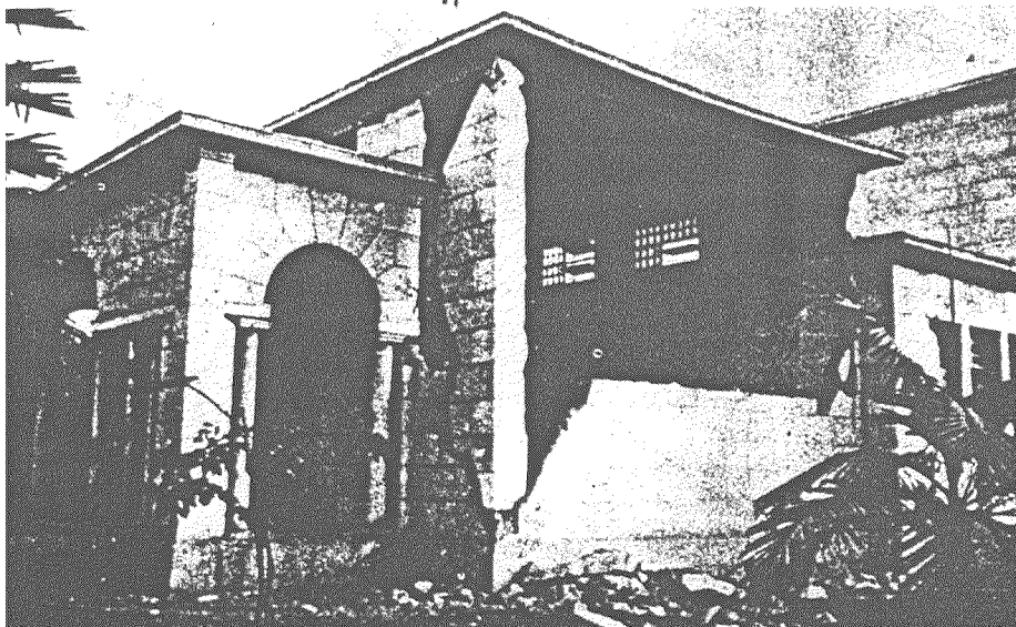
Foto No. 5. – Desplome de pared y agrietamientos en edificio de la Escuela Nacional de Agricultura (La Molina), después del terremoto de Lima del 24 de Mayo de 1940. (Gentileza del Ing. R. Valencia).
