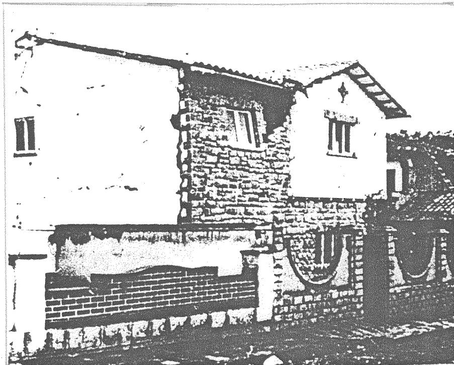
Foto No. 10.— Agrietamientos en paredes de casa, después del terremoto del Cuzco, el 21 de Mayo de 1950.
