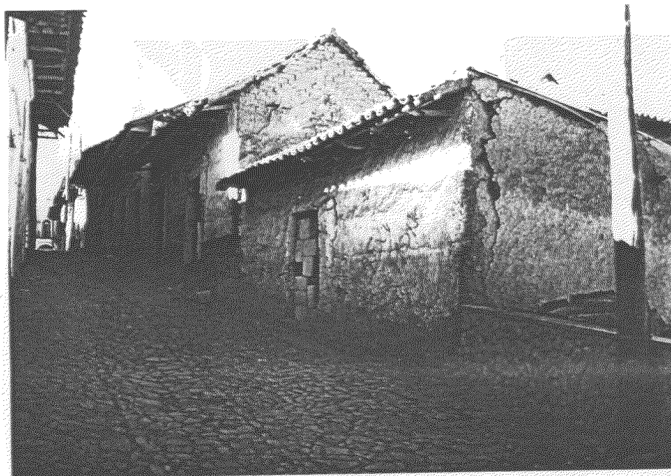
Foto 3. Daño en vivienda de la localidad de Totora
