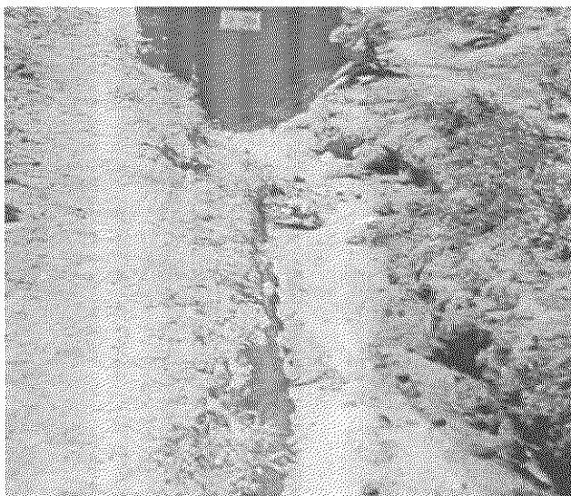
Erosión hídrica en el camino de acceso hacia Aguas Calientes
