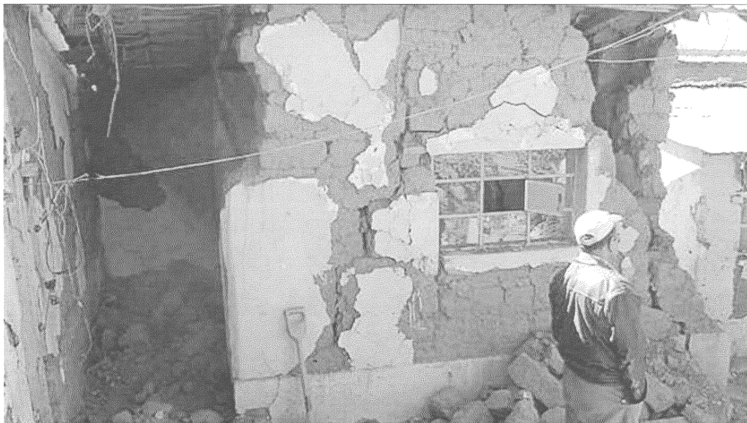
Dstrucción de una casa habitacional de adobe ubicada en Arequipa, a consecuencia del terremoto en el año 2001
