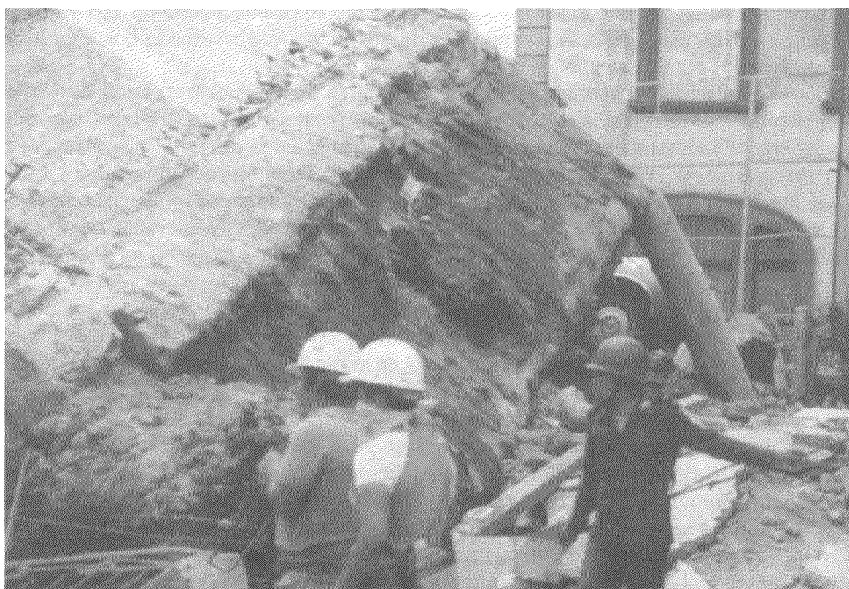
Fig. 23(b) —Vista de detalle mostrando el arrancamiento de un pilote de rozamiento.
