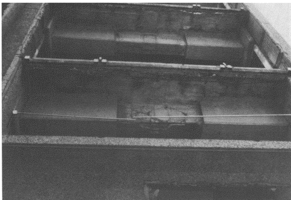
(2) Detalle de daños en las jácenas reacondicionadas.
