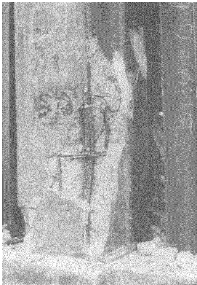
Fig. 48(b) Fallo a cortante del pilar de la 1ª planta.
