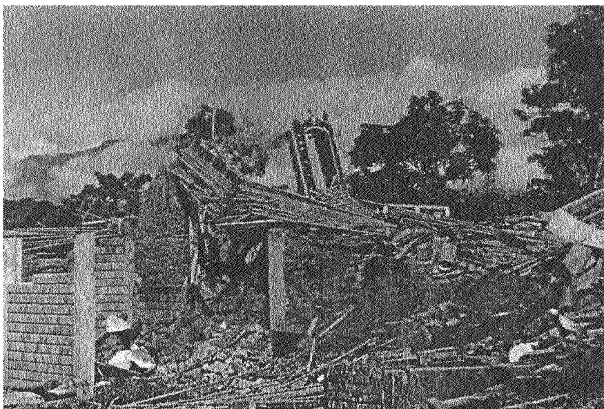
Foto 24 Soritor: Iglesia colapsada totalmente
