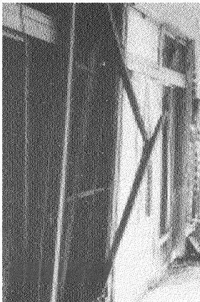
Fotografía 1. Falla por pandeo de diagonales de arriostramiento.
