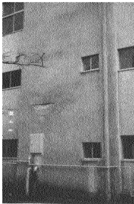
Fotografía 10. Muros del marco exterior, entre los ejes 13 y 14 ( {}_1W_{A13-A14} ). El nivel de daño de las columnas de borde {}_1C_{A13} , {}_1C_{A14} , es igual a I
