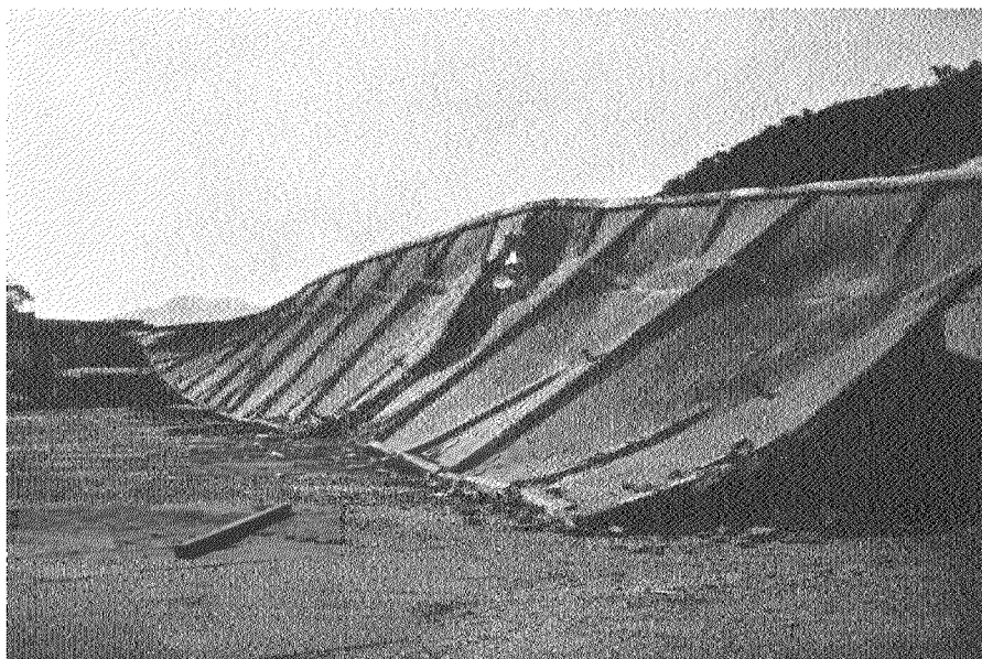
Fotografía 14. Falla total de la estructura de la techumbre, y apuntalamiento (para posterior demolición) de la parte que quedó en pie.
