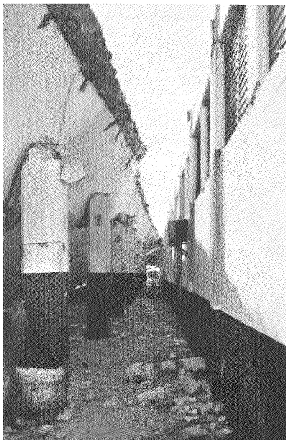
Fotografía 15. Articulaciones plásticas en la parte superior de las columnas soporte de la estructura de la techumbre. Se observa el insuficiente o nulo anclaje del refuerzo longitudinal de las columnas en el sistema de techo. En la parte derecha de la fotografía se encuentra el edificio del cuerpo central, por lo que también se aprecia el desprendimiento de algunas de las cinco grapas que trataban de mantener un comportamiento monolítico entre los dos cuerpos.
