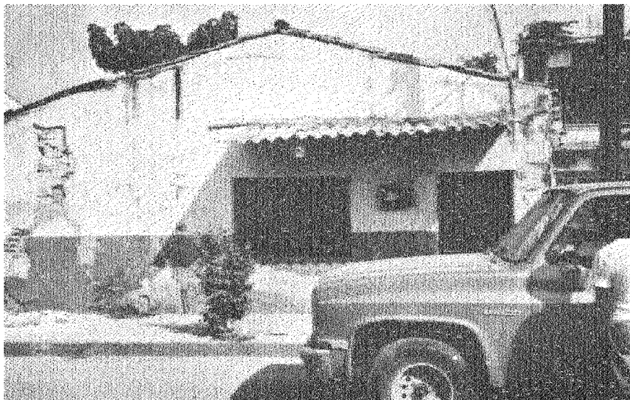
Fotografía 33. Edificación de mampostería confinada con daño menor o ligero (II).
