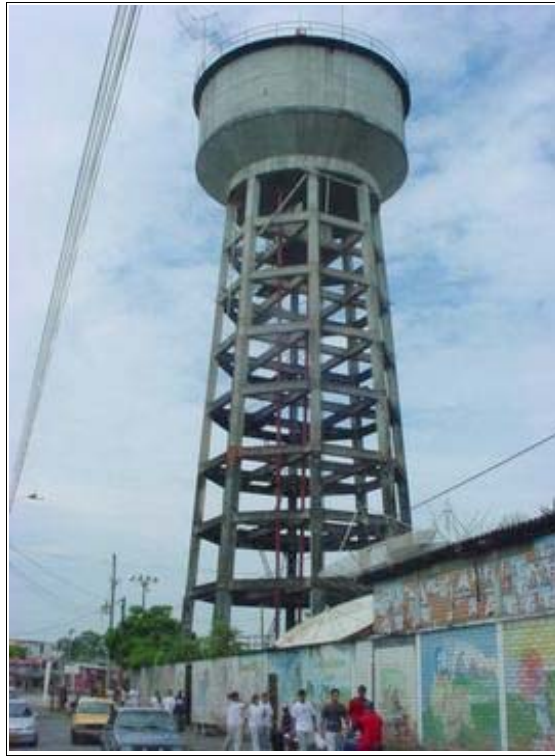
Foto 15. Tanque San Judas, Sector 8, sobre terrenos potencialmente licuables.
