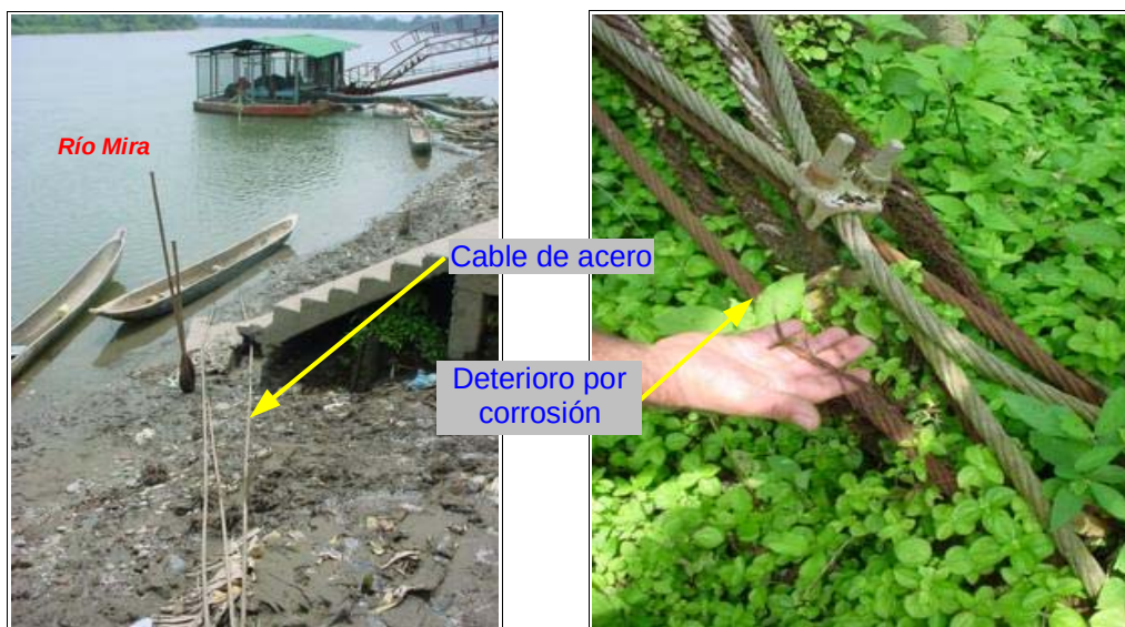
Foto 13. (a) Cable de barcaza; (b) detalle de cable deteriorado.
