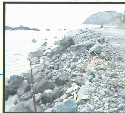
Palma Mocha, este tramo de carretera aledaña a la costa que sufre los embates de las olas.
