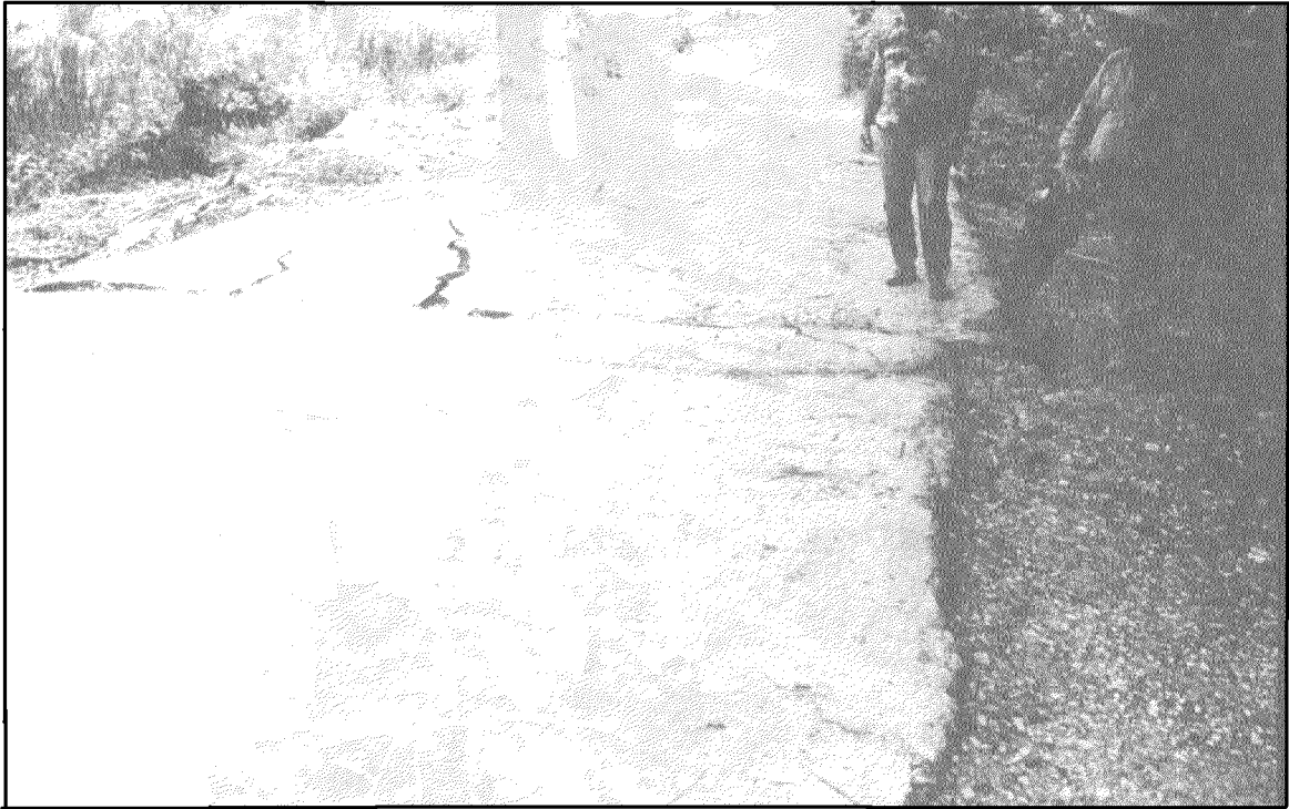
Foto 38. Desplazamiento cosísmico a nivel de la carpeta asfáltica al norte de la troncal 10
