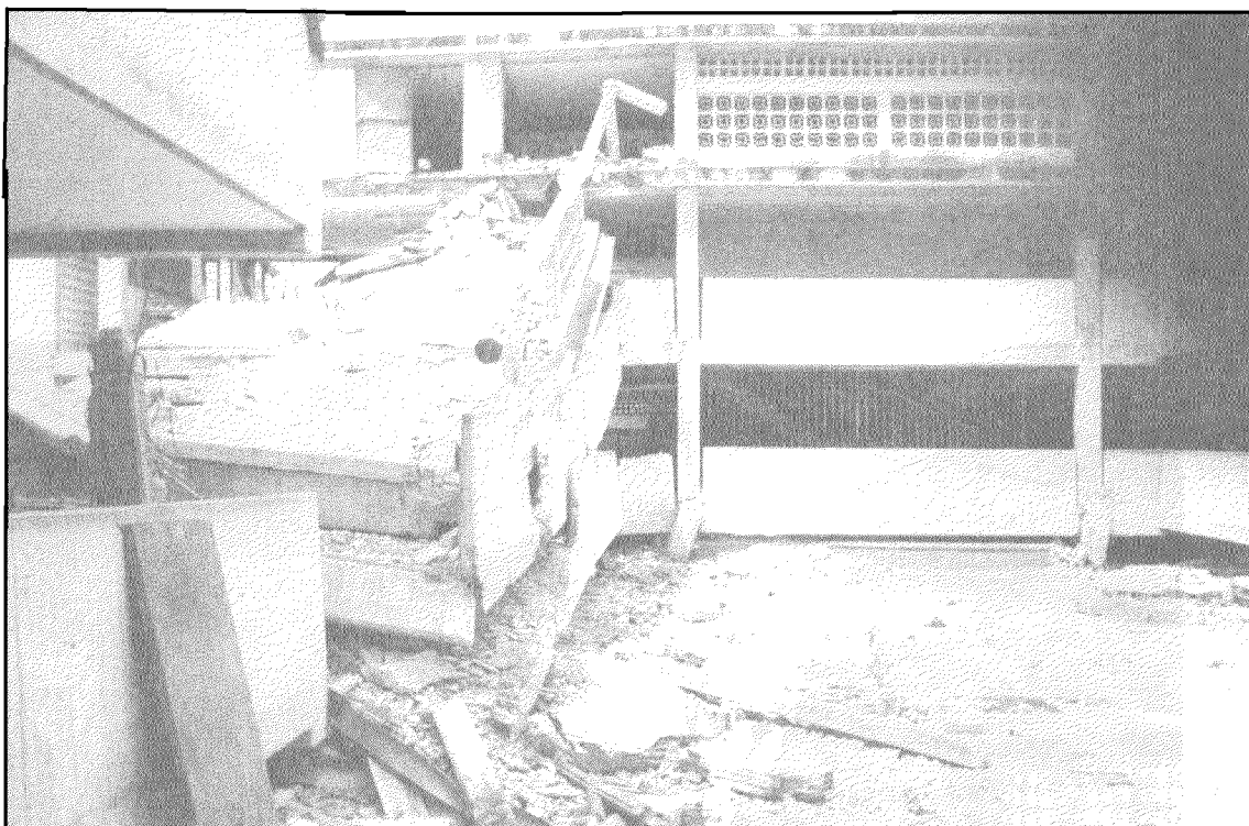
Foto 71. Colapso en serie de tres niveles de un ala del Liceo Raimundo Martínez, así como el colapso de las columnas de planta baja, Cariaco.
