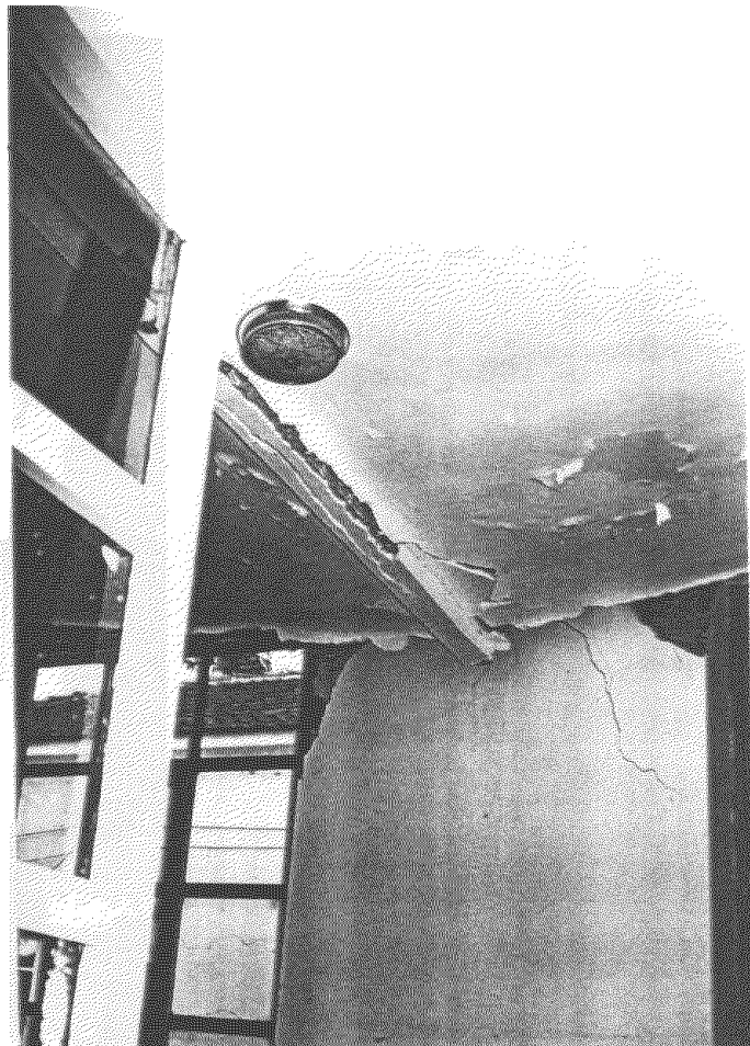
Foto 22. Daño del cielo falso del auditorium del Hospital Carmen López
