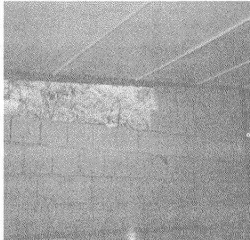
Figura Nº 20 Falla en paredes de bloques en aula Galindo.
