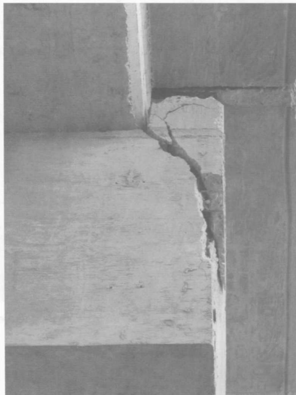
Figura 6.6 Daño en tope del puente "Manzanillo"
