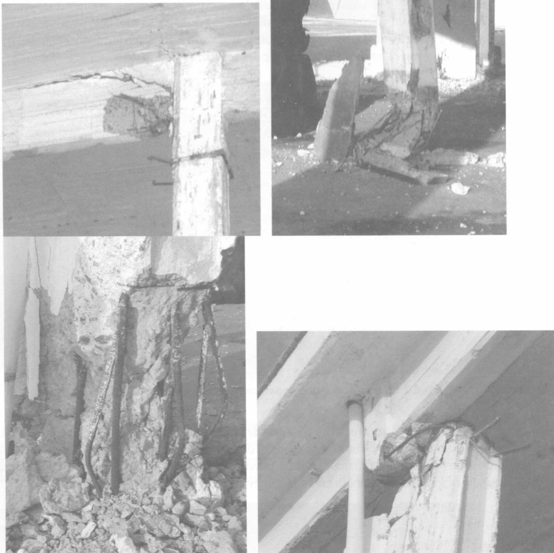
Figura 6.4 Detalles de daño en la estructura
