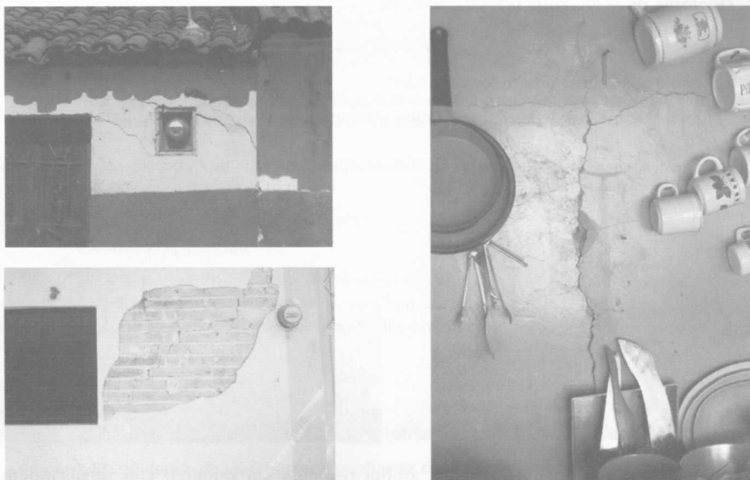
Figura 7.77 Agrietamiento diagonal de muros
