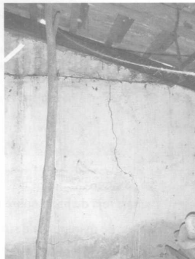
Figura 7.79 Agrietamiento vertical en muros cabeceros
