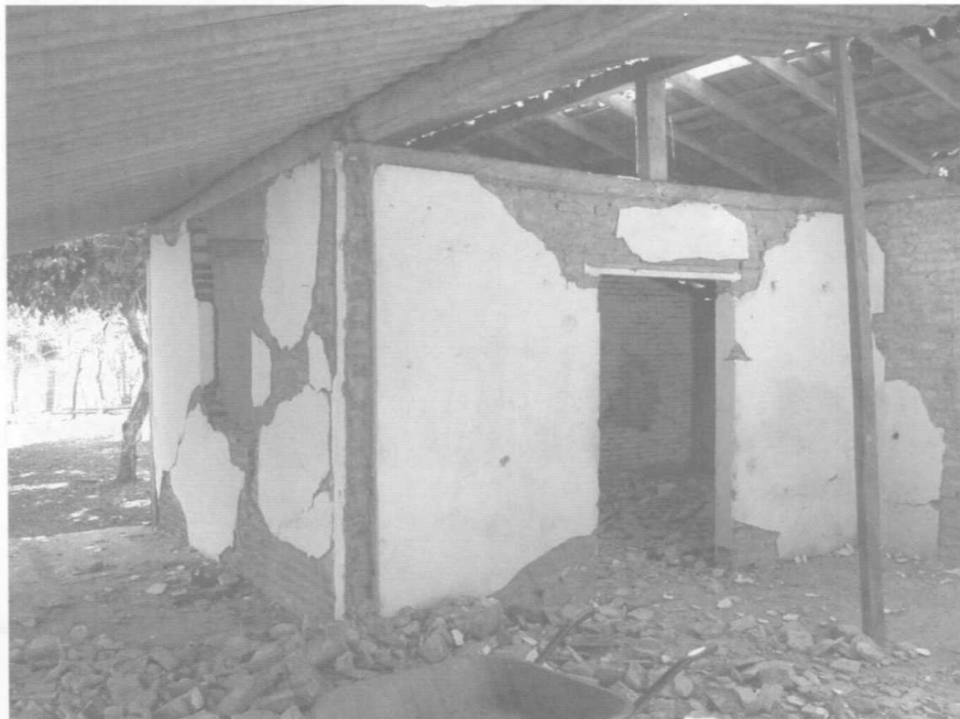
Figura 7.117 Daños en viviendas de mampostería simple
