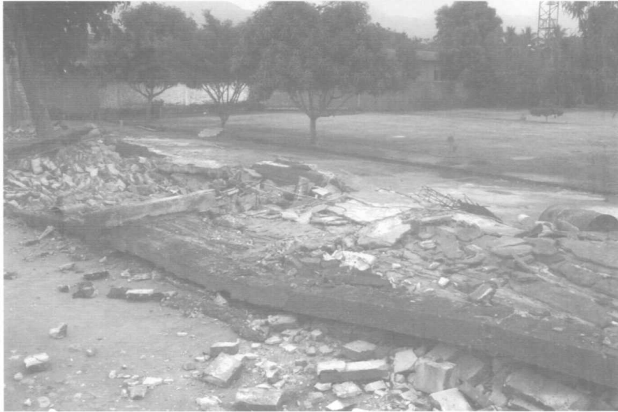
Figura 7.116 Bardas de mampostería con defectos en el refuerzo
