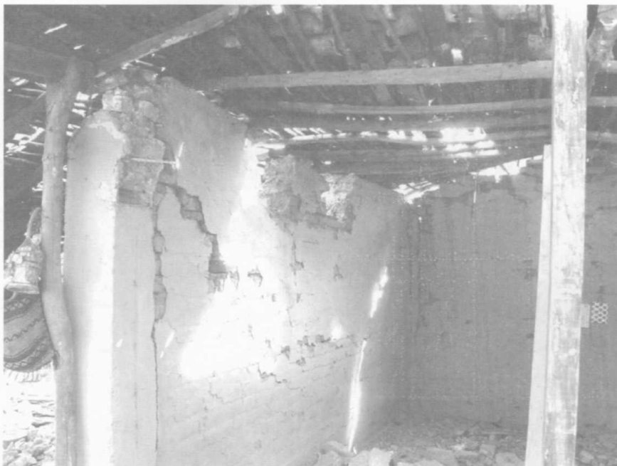
Figura 7.114 Daño severo en una vivienda de adobe debido a la falta de una dala de cerramiento
