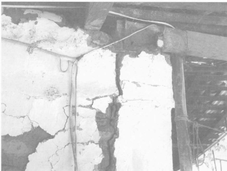
Figura 7.115 Daño en un muro de adobe a causa de una mala liga del castillo y la dala de cerramiento
