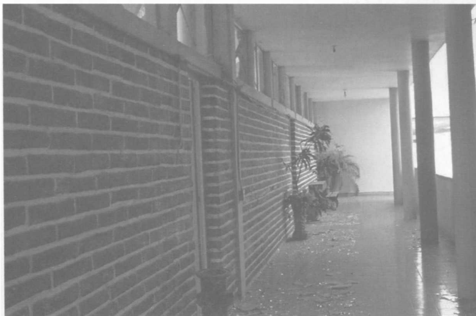
Figura 8.18 Rotura de vidrios en un edificio escolar
