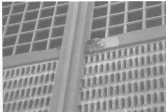
Figura 10.3 Daño en los extremos de traves (articulaciones plásticas)
