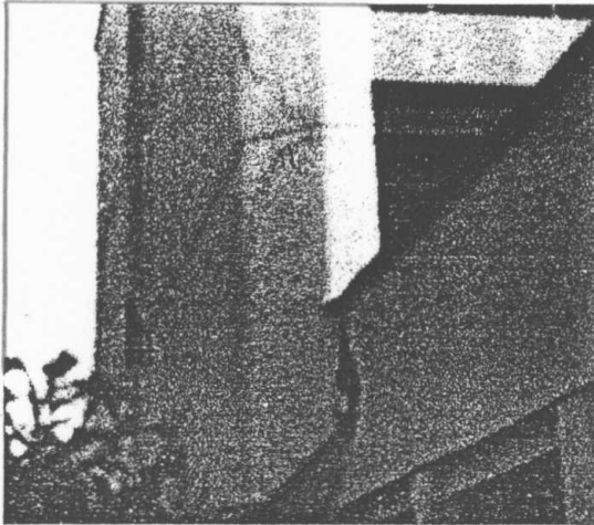
FACHADA ESTE, JUNTA ENTRE BLOQUES PRINCIPAL Y DE CONSULTA EXTERNA
