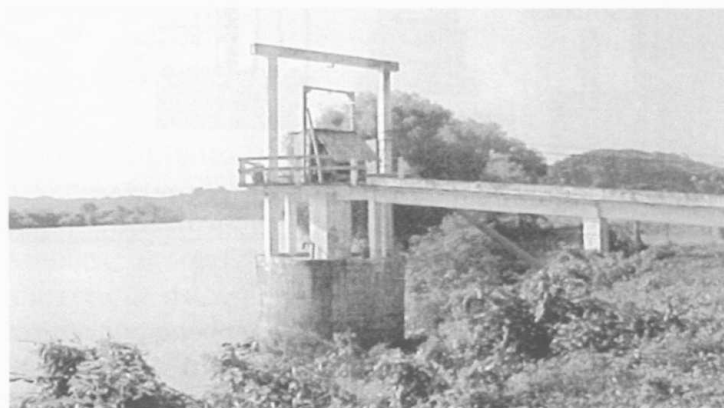
Figura 35 Estación hidrométrica en el río Tecolutla, Veracruz
