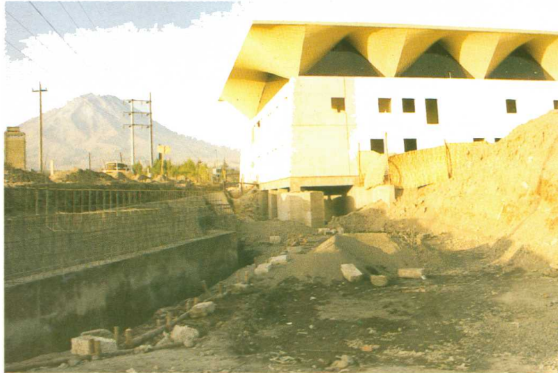
TERMINAL TERRESTRE DE AREQUIPA. LAS COLUMNAS DE SU FACHADA LATERAL ESTÁN CIMENTADAS EN PLENA TORRENTERA.
