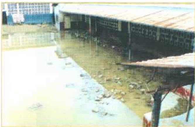
MAL DRENAJE DE PATIOS Y AREAS VERDES
