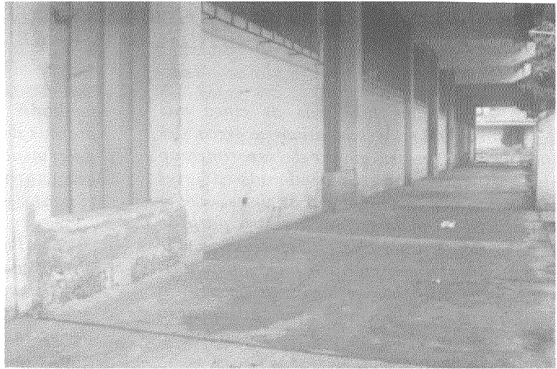
La sabiduría popular ha sabido con su ingenio aplicar medidas no estructurales como la construcción de muros de mampostería para evitar el ingreso del agua a las aulas.
