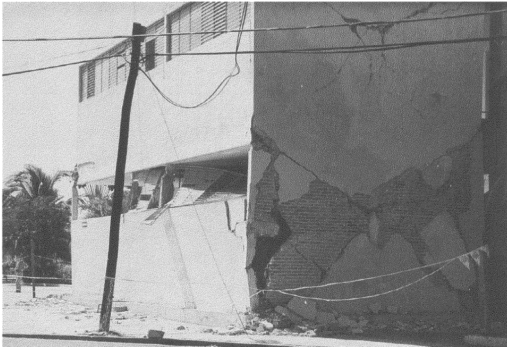
Foto 13.- Daño severo observado en los muros de mampostería de la estructura de dos niveles ubicada en la parte Este del complejo [1].
