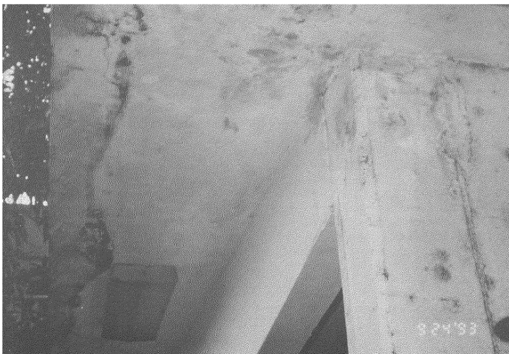
Foto 17.- Desprendimiento del recubrimiento de concreto y exposición del acero de refuerzo.
