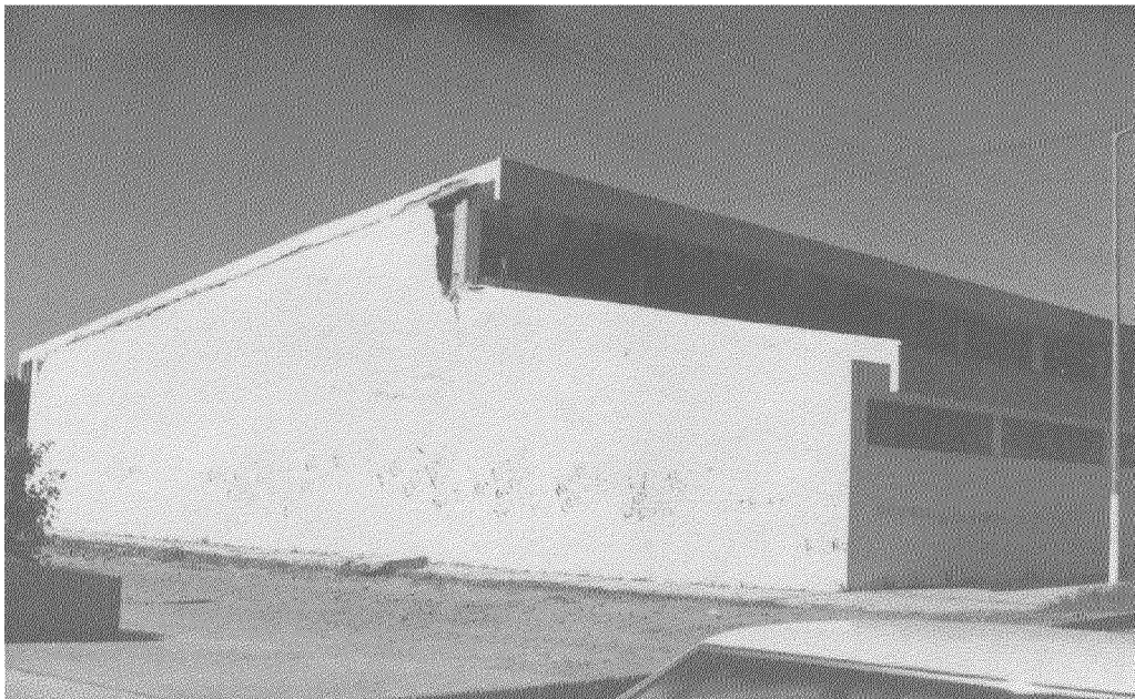
Foto 16.- Fachada Sur del edificio de correos en la cual se aprecia el daño en la columna que soporta el volado en el lado Este de la estructura [1].
