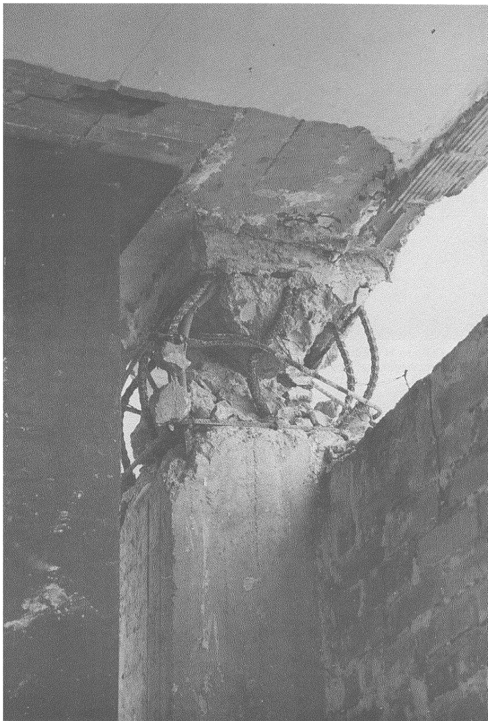
Foto 22.- Falla por cortante en la parte superior de las columnas de la planta baja en la colindancia Noroeste [1]
