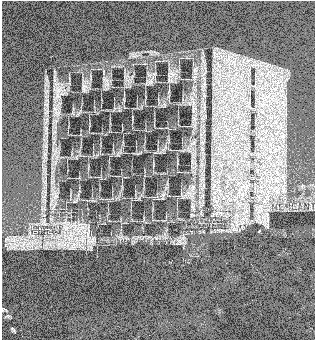
Foto 39.- Hotel Costa Brava después del sismo de 1985 [1].
