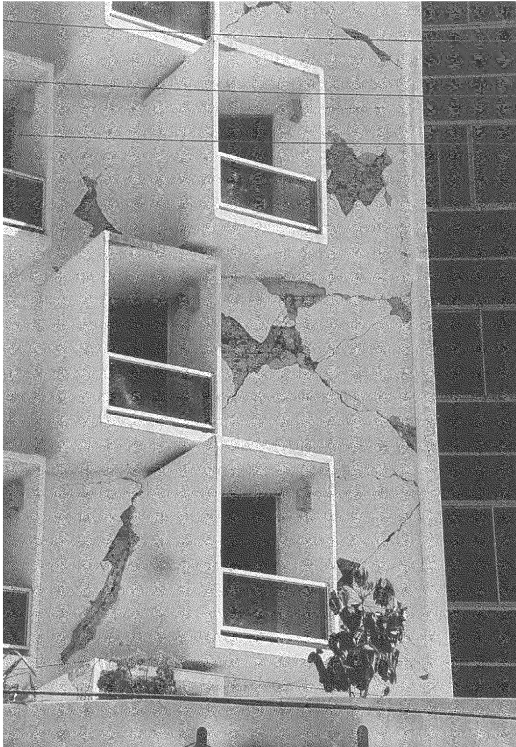
Foto 40 - Agrietamiento por cortante en muros de mampostería de la fachada principal [1].
